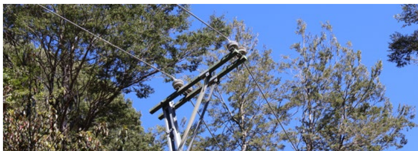
Figura 2.9. En algunos países existen líneas de distribución de media tensión monofásicas que portan dos cables, un conductor y un neutro. Línea monofásica en el Parque Nacional Huerquehue, Chile. © Mario Durán/GREFA
