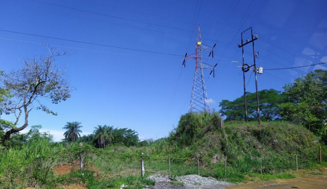
Figura 7.14. A la hora de evaluar la peligrosidad de una línea, es importante tener en cuenta otros factores además de sus características, como la presencia de fuentes de agua o la densidad de presas en las cercanías. Líneas eléctricas en Panamá. HighVoltage 5576 vía Wikimedia Commons. CC BY-SA 4.0
