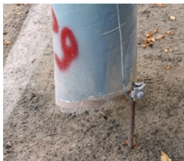
Figura 2.12. La puesta a tierra es un sistema de protección contra rayos y sobretensiones, que proporciona seguridad tanto a la línea como a los operarios que trabajen en ella. Puesta a tierra de un poste de media tensión. © Justo Martín
