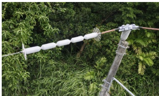
Figura C.8. Colocación de barrera giratoria sin espinas. © Luis Diego Carballo (Electrificadora ESPH)
