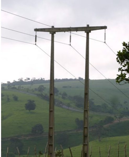
Figura 4.20. El uso de diseños seguros para las aves es la mejor medida para minimizar el riesgo de electrocución. Cruceta con aisladores suspendidos, con distancias seguras entre los conductores y las zonas de posada. Línea de distribución en Brasil. © Álvaro Camiña
