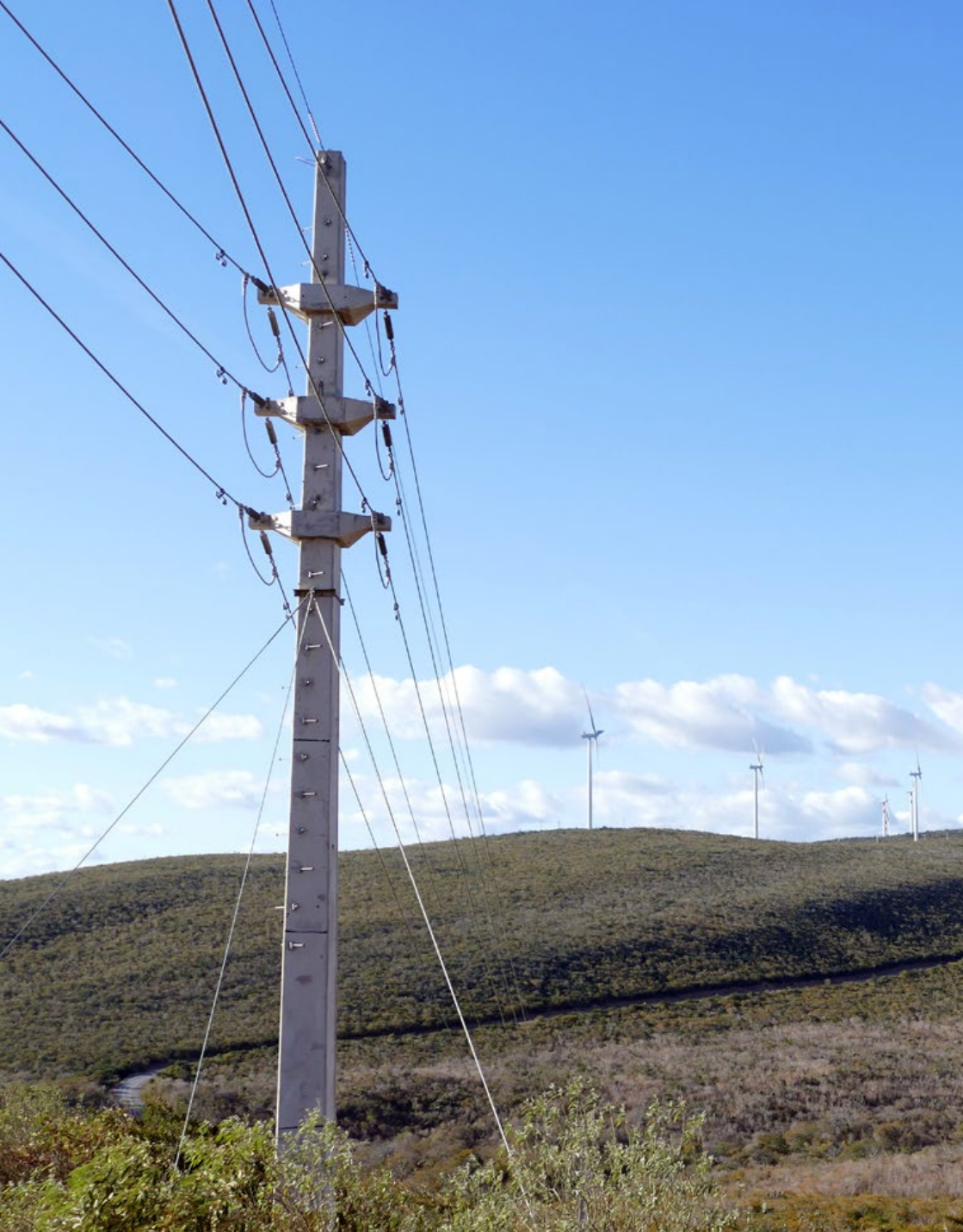
Figura i.2. Las líneas eléctricas son un elemento común en los paisajes de muchas regiones del mundo, cada vez más, impulsadas por la descarbonización y progresiva electrificación de la economía. Línea eléctrica en Brasil asociada a un parque eólico. © Álvaro Camiña
