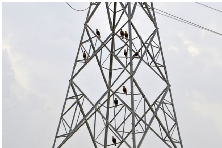
Figura 5.9. Las ubicaciones próximas a sitios de concentración de aves deben considerarse situaciones de alto riesgo de colisión. Grupo de caranchos ( Caracara plancus ) en torre de transmisión, Uruguay. © Pablo G. Fernández
