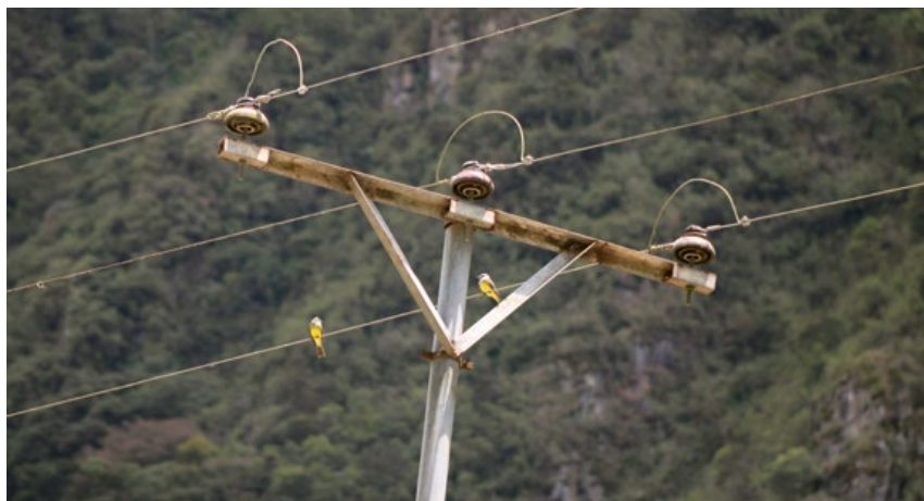
Figura i.4. Con la implantación de las medidas adecuadas, las líneas eléctricas pueden coexistir con las especies que habitan los ecosistemas que atraviesan minimizando sus impactos. Tendido eléctrico con un diseño de riesgo para ciertas especies (Perú). © Giuliana Atalaya
