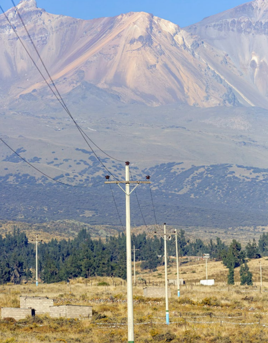
Figura 8.11. Una planificación estratégica adecuada incorpora al análisis los elementos para minimizar los impactos del desarrollo de infraestructuras. Línea de distribución con tipología de postes peligrosa para las aves que se posen, Cacayaco, Perú. © Pedro E. Allasi C.
