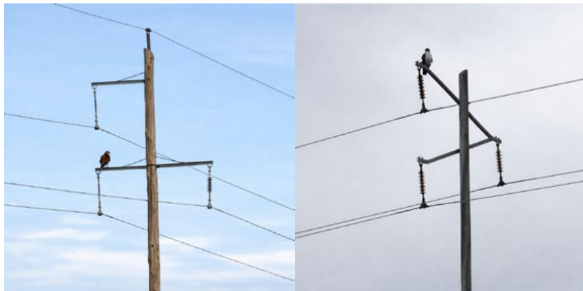
Figura 9.3. Dos ejemplos del empleo de líneas de distribución de energía con tipo constructivo de amarres suspendidos en Argentina. En ambos casos se puede observar que la disposición de cables conductores hace imposible el contacto con el ave. A la izquierda un aguilucho común ( Buteo polyosoma ) en la provincia de Mendoza y, en la imagen de la derecha, un individuo de la misma especie posado sobre una cruceta de tipo “canadiense” en Península de Valdez, Chubut. © José Hernán Sarasola/CECARA
