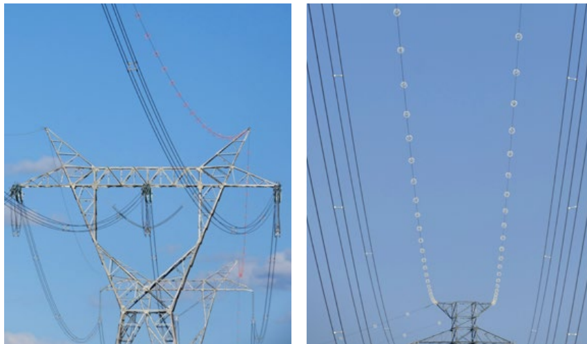
Figura 5.13. Dispositivos anticolidión instalados en una línea de transmisión sobre un solo cable de guarda, Uruguay (izquierda) y sobre los dos en un patrón alterno, España (derecha). © Pedro Rivero (izq.) y Justo Martín (dcha.)
