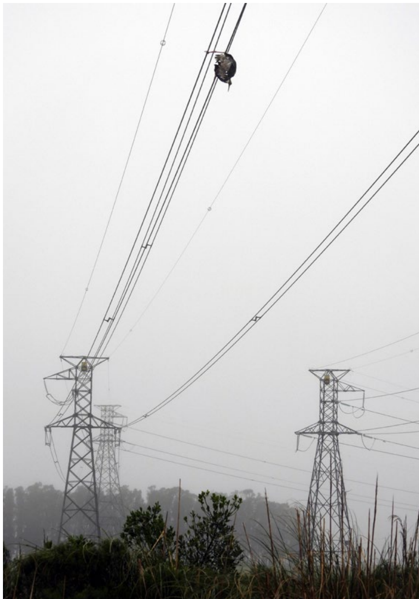
Figura 7.20. La mortalidad suele concentrarse en ciertos tramos o postes, "los puntos negros"; el principal objetivo de los trabajos de campo es encontrarlos para remediar el impacto. Punto de colisión en Rio Grande do Sul, Brasil. © Diógenes Arruda
