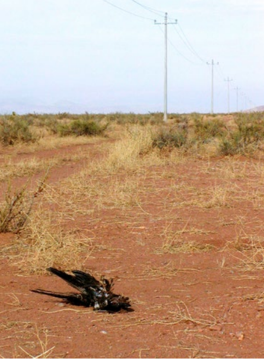
Figura 4.17. Las electrocuciones se concentran en postes con una configuración peligrosa y/o donde la topografía y hábitat favorecen su uso por aves u otros animales, especialmente si el alimento es abundante. En la fotografía, línea eléctrica de distribución donde los postes, por su configuración, favorecen los incidentes con la fauna, que además se sitúa en zona desértica, sin otros posaderos disponibles. © Rick Harness
