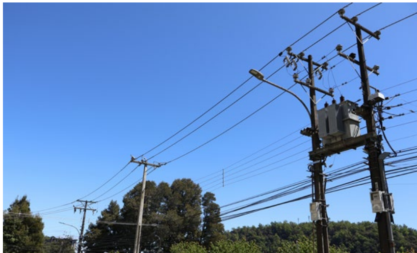
Figura 2.7. En las líneas de media tensión y voltajes superiores los cables suelen estar desnudos; solo en determinadas circunstancias se utilizan cables cubiertos en esos voltajes. Línea de media tensión con cables cubiertos en Chile. © Mario Durán/GREFA
