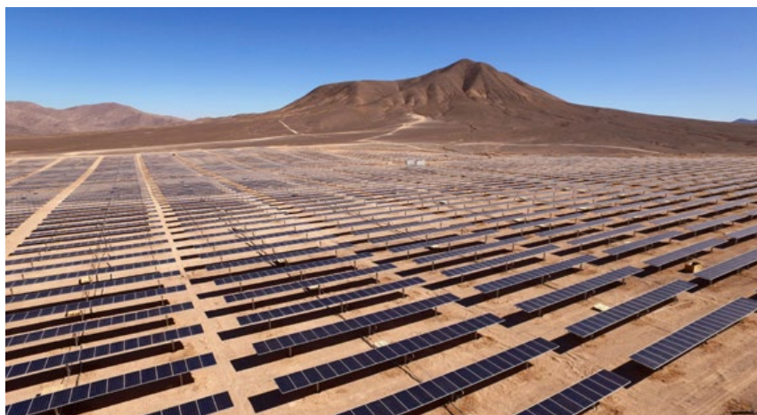
Figura 2.3. Las plantas solares fotovoltaicas producen electricidad a través de las células fotovoltaicas, capaces de captar la luz solar y convertirla en electricidad. Central fotovoltaica en Antofagasta, Chile. © Antonio García/Unsplash
