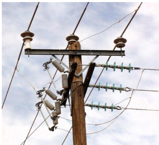
Figura 2.23. Poste especial, de derivación, equipado con cortacircuitos fusibles de expulsión. © Rick Harness
