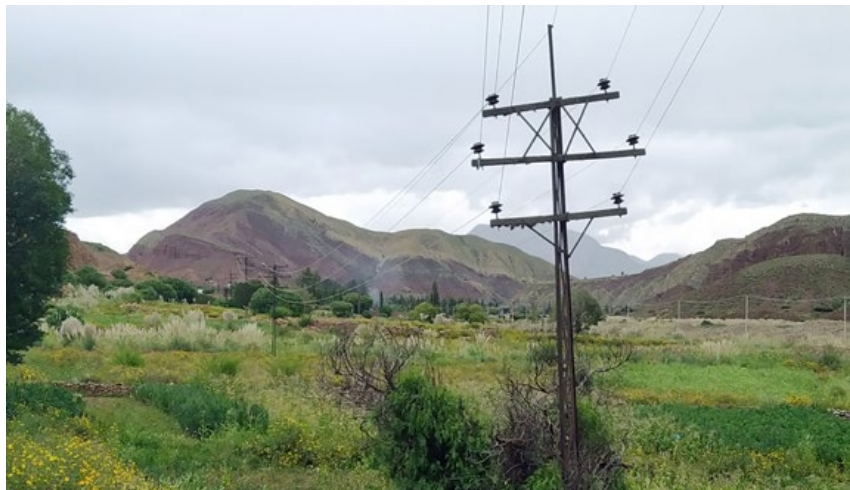
Figura 7.7. En los proyectos de nuevas líneas eléctricas es importante una buena recopilación de información previa, tanto de las líneas ya existentes como de la presencia de especies sensibles. Línea eléctrica en Yocalla, Bolivia. HighVoltage 5576 vía Wikimedia Commons. CC BY-SA 4.0
