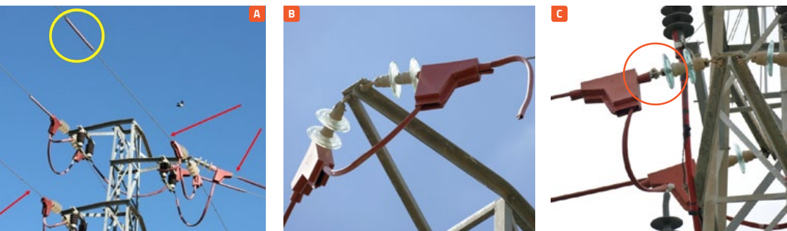
Figura 4.30. Ejemplos de instalaciones de aislamiento defectuosas (España). A: fundas aislantes instaladas sin elementos de retención, que se han desprendido y desplazado a lo largo del conductor, dejando al descubierto el tramo más próximo a las zonas de posada de las aves; B: funda aislante que se ha desprendido por el extremo debido a un mal ajuste y sujeción; C: el aislamiento no cubre toda la parte metálica, dejando un punto en tensión en la zona más próxima al posible punto de posada. © Justo Martín
