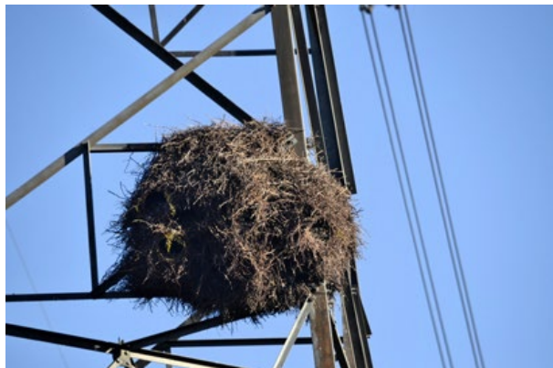
Figura 1.5. Las líneas eléctricas pueden ser beneficiosas para ciertas especies de aves al permitir que aniden, se posen y duerman en los postes. Nido de cotorra argentina ( Myopsitta monachus ) en una torre de una línea de transmisión en Uruguay. © Pablo G. Fernández
