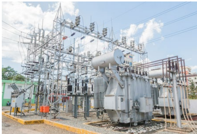
Figura 2.5. En las subestaciones, la electricidad de las líneas de transmisión se reduce en voltaje y luego se transfiere a las líneas de distribución. Subestación en la República Dominicana. © Aldward Castillo, Unsplash
