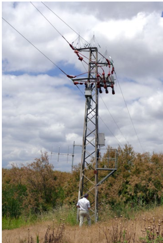
Figura 8.4. Los técnicos y trabajadores de las empresas eléctricas deben recibir formación sobre los procedimientos adecuados para inspeccionar las medidas preventivas y de mitigación, así como para supervisar su eficacia. Revisión del estado de medidas antielectrocución, Andalucía, España. © Justo Martín
