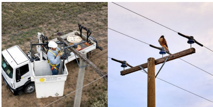
Figura 9.4. Implementación de cobertores aisladores en uno de los diseños más comunes en Argentina, como son las líneas trifásicas con cables o fases en un mismo plano apoyadas en crucetas horizontales y aisladores rígidos verticales. © José Hernán Sarasola/CECARA
