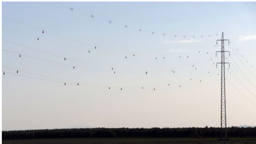
Figura 5.15. Los marcadores con elementos móviles y reflectantes parecen ser los más eficaces. Además, son sencillos de instalar y no requieren cortes del suministro. Línea equipada con dispositivos fijos en el cable de guarda y dispositivos móviles reflectantes en los conductores, España. © Justo Martín
