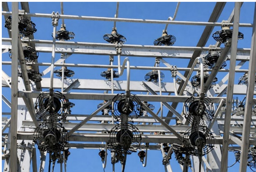
Figura C.11. Dispositivos electrostáticos instalados en aislantes de porcelana provistos de fusibles de una subestación. © Ezequiel Herrera/CNFL
