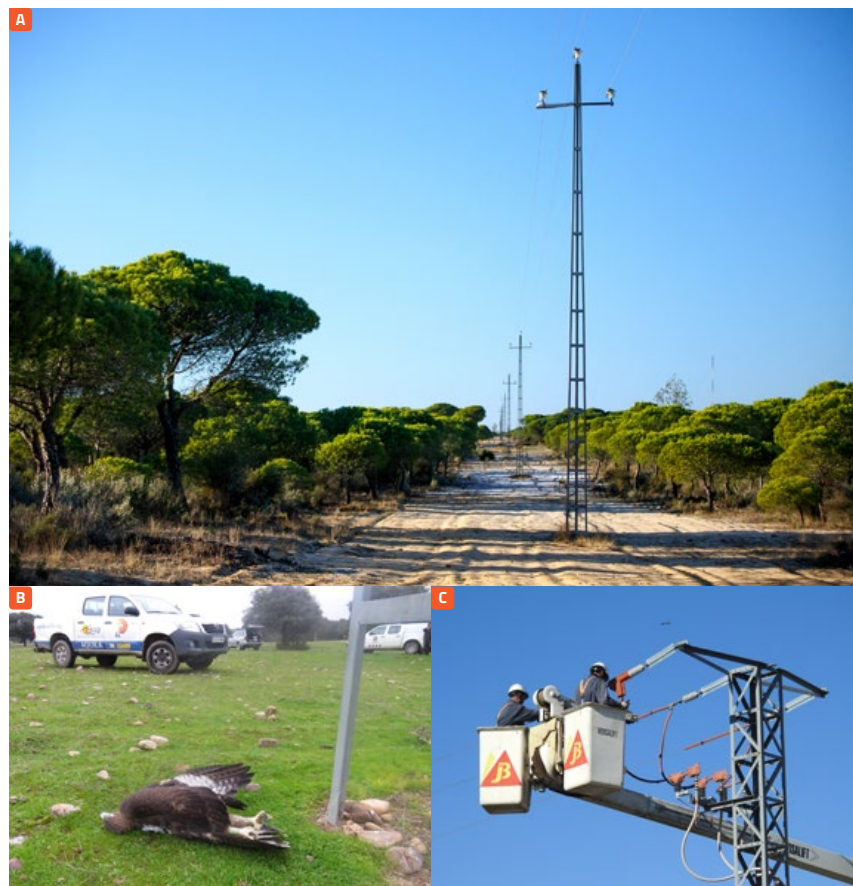
Figura 9.16. A: línea eléctrica con configuración peligrosa para las aves en el Parque Nacional de Doñana; B: águila perdicera encontrada electrocutada por el equipo de AQUILA a-LIFE; C: técnicos de la compañía eléctrica modificando un poste peligroso. España. © Daniel Burón (A) y AQUILA a-LIFE-GREFA (B, C)
