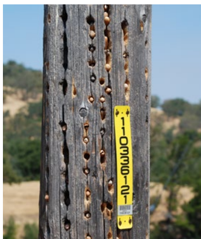
Figura 3.14. La acción de los picamaderos en los postes de madera puede llegar a producir grandes daños económicos. Por Olekinderhook vía Wikimedia Commons. CC BY 3.0
