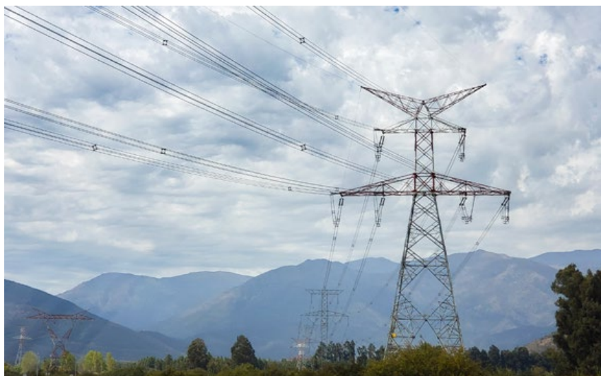
Figura 5.11. A diferencia de la electrocución, la adopción de medidas estructurales no es la mejor solución para prevenir colisiones, debido a su elevado coste y a su eficacia no probada. Línea de transmisión en doble circuito con tres niveles de cables en la Región de O'Higgins, Chile. Por ShootingStarMax vía Wikimedia Commons. CC BY-SA 4.0
