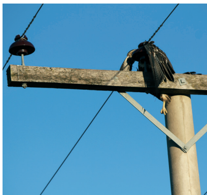
Figura 6. Los apoyos de las líneas eléctricas pueden ser especialmente peligrosos cuando son contruidos con materiales conductores. Aun cuando se construyan empleando crucetas de madera (baja conductividad) las aves pueden posarse en el ápice del poste de hormigón (conductor) y resultar electrocutadas al tocar la fase o conductor más próximo como es el caso del águila mora en la imagen. La intervención del tendido para evitar nuevas mortandades requiere la aislación de cables desde el aislador vertical sobre la cruceta hacia ambos sentidos de la línea del tendido.
