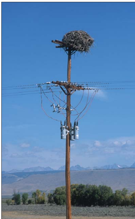
FIGURA 6.16: Nido de águila pescadora en Wyoming sobre un poste terminal doble. El material del nido que pudiera caer sobre los conductores o el equipamiento representa un riesgo de incendio, interrupciones eléctricas y daño al equipamiento.
