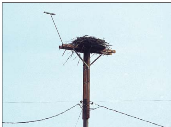
FIGURA 6.11: Plataforma de anidación construida sobre un poste usando crucetas para extenderla sobre los conductores. Este diseño también incluye una percha opcional elevada para atraer a las águilas pescadoras. La percha debe ser perpendicular al viento predominante.
