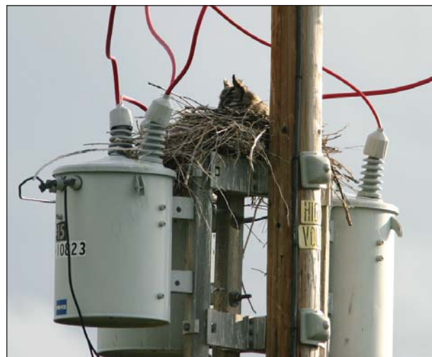
FIGURA 4.5: Nido de búho cornudo en un banco de transformadores.
