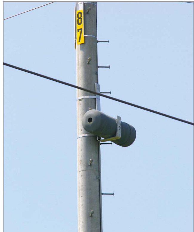
FIGURA 6.19: Tubo de anidación de cernícalo (longitud 91 cm [36 in]) instalado en una torre de transmisión en Georgia.
