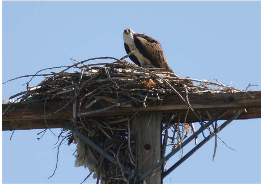
FIGURA 6.2: Nido de águila pescadora en cruceta doble de poste no energizad.
