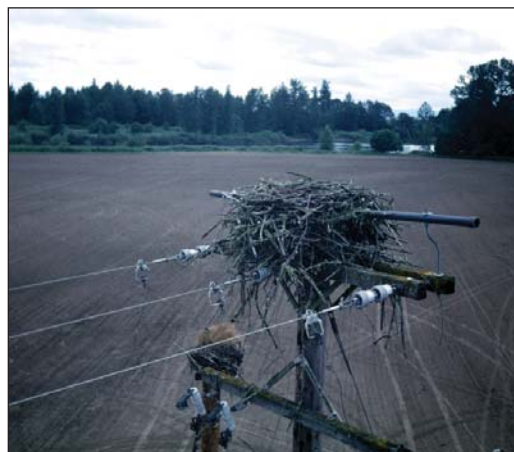
FIGURA 6.23: Segmento de tubería plástica instalado en un poste terminal en Oregon para desalentar anidación de águilas pescadoras. Sin embargo, la pareja de águilas pescadoras continuó la construcción del nido después que la tubería fue instalada.
