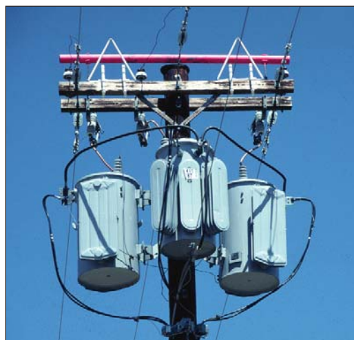
FIGURA 6.24: Una tubería montada sobre los conductores puede ser utilizada para desalentar la anidación en los postes de distribución con aisladores montados sobre las crucetas. Los triángulos se deben utilizar con precaución, ya que pueden ayudar a acumular material para el nido. Este diseño puede representar un riesgo de electrocución si no se cubren el equipamiento expuesto y los conductores o no se espacian adecuadamente.
